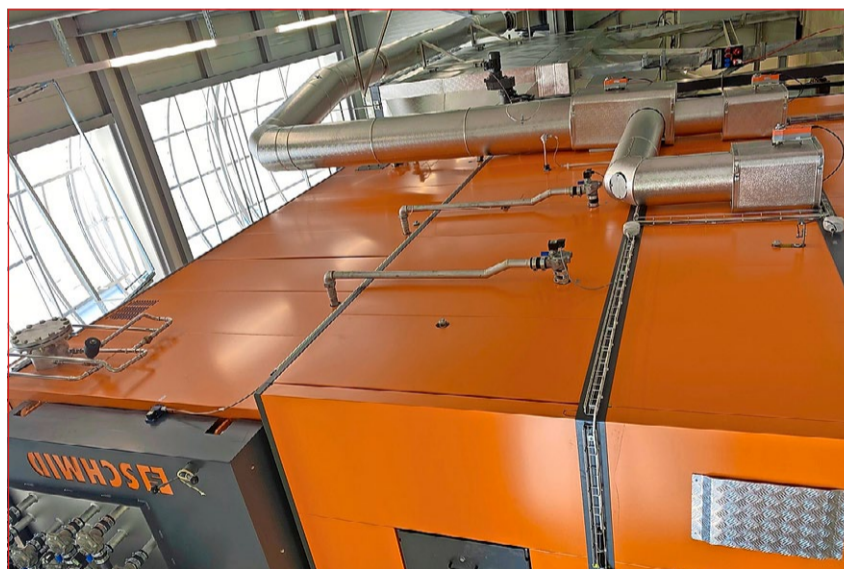
Der grosse Holzkessel im Innern des Wärmeverbund-Gebäudes. Foto: zvg
