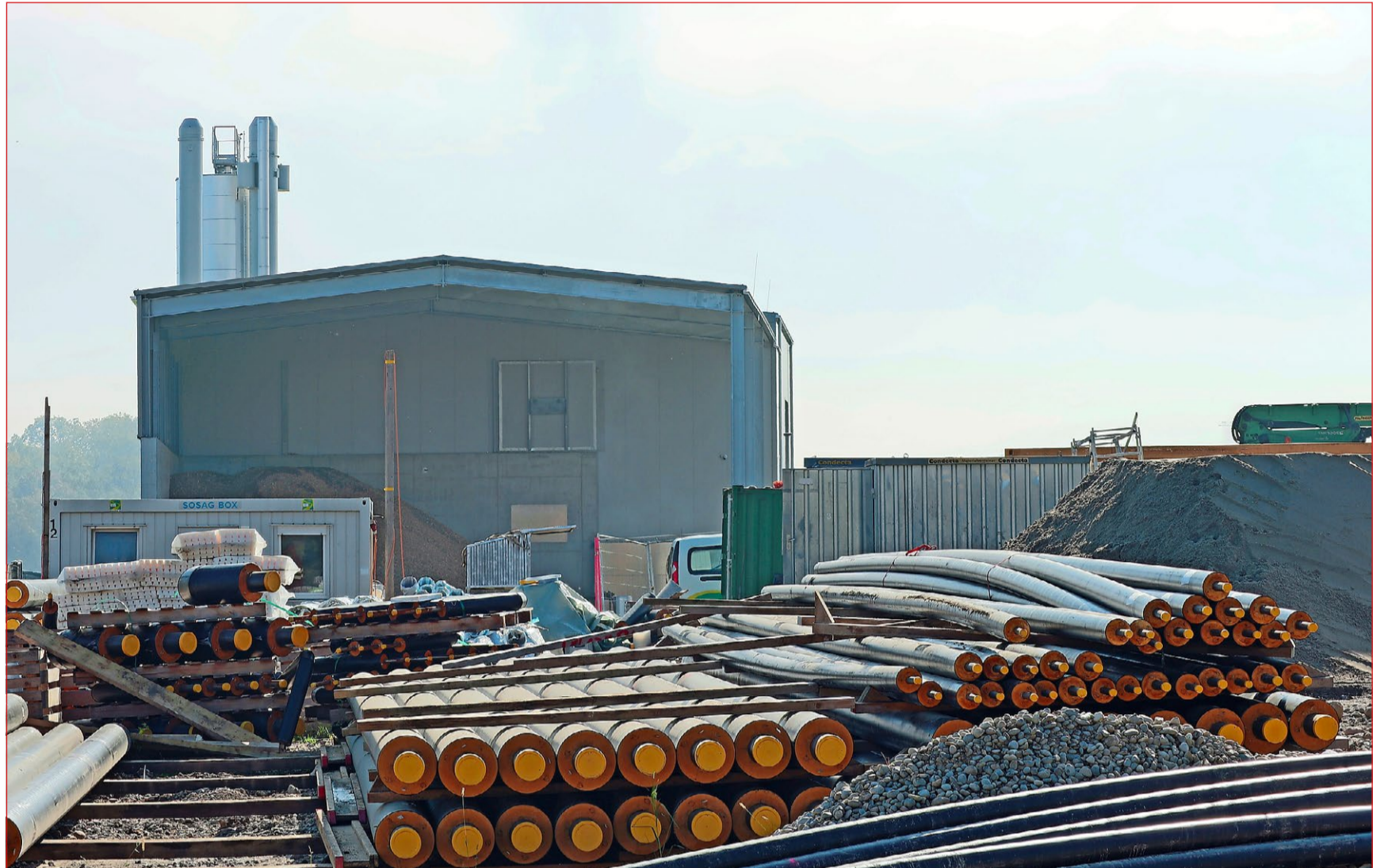
Die Heizzentrale des Wärmeverbundes steht. Leitungen für die Erweiterung sind wegen möglicher Lieferschwierigkeiten bereits eingekauft. Foto: Bettina Sticher
